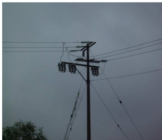
FOTO: Líneas aéreas de distribución.
