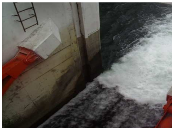
FOTO: Compuerta en presa derivadora "La Aguja"
