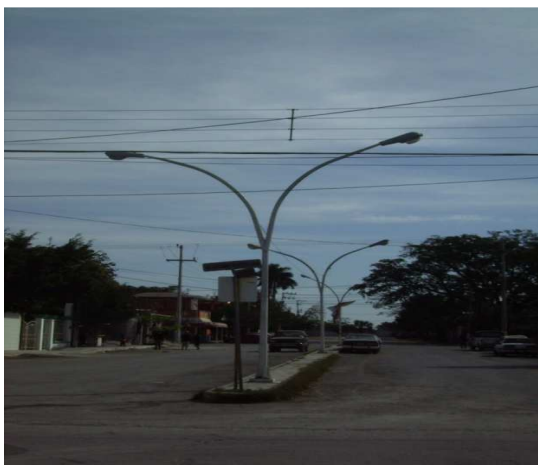
FOTO: Luminaria tipo en vialidades primarias
