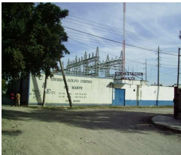
FOTO: Subestación 5 de Mayo en cabecera municipal
