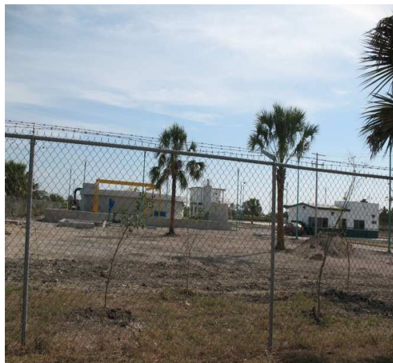
FOTO: Nueva planta de tratamiento de aguas al norte de la mancha urbana.
