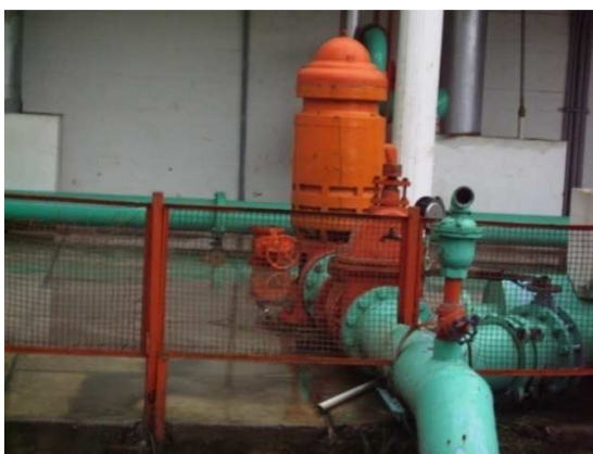
FOTO: Línea de conducción y bombeo Mante II
