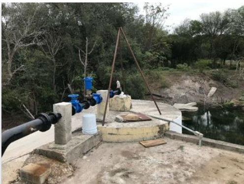
Cárcamo con equipo de bombeo a línea de conducción.
