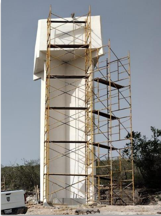
Tanque elevado con capacidad de 10m 3 en San Carlos.
