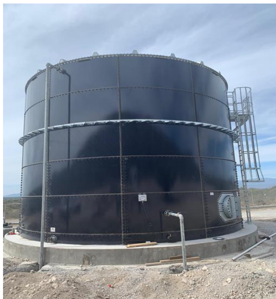
Tanque de almacenamiento con capacidad de 500 metros cúbicos.
